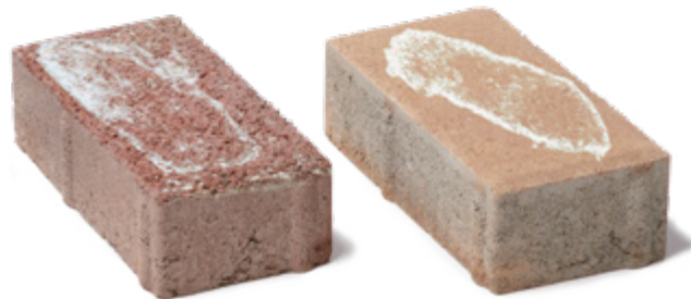
Dlažba s výkvětem
