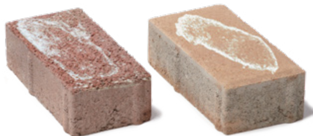
Dlažba s výkvětem
