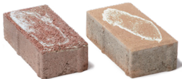
Dlažba s výkvětem
