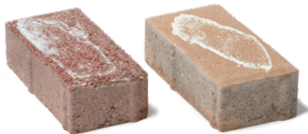
Dlažba s výkvětem
