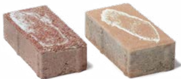
Dlažba s výkvětem
